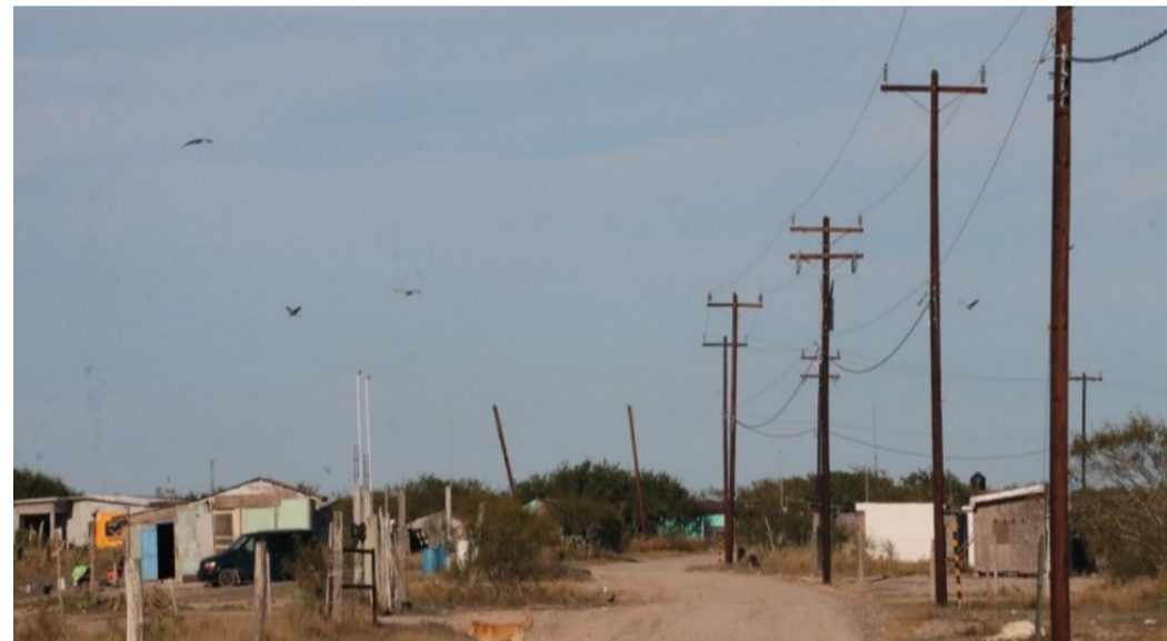
La red eléctrica en La Capilla (diciembre 2020)
