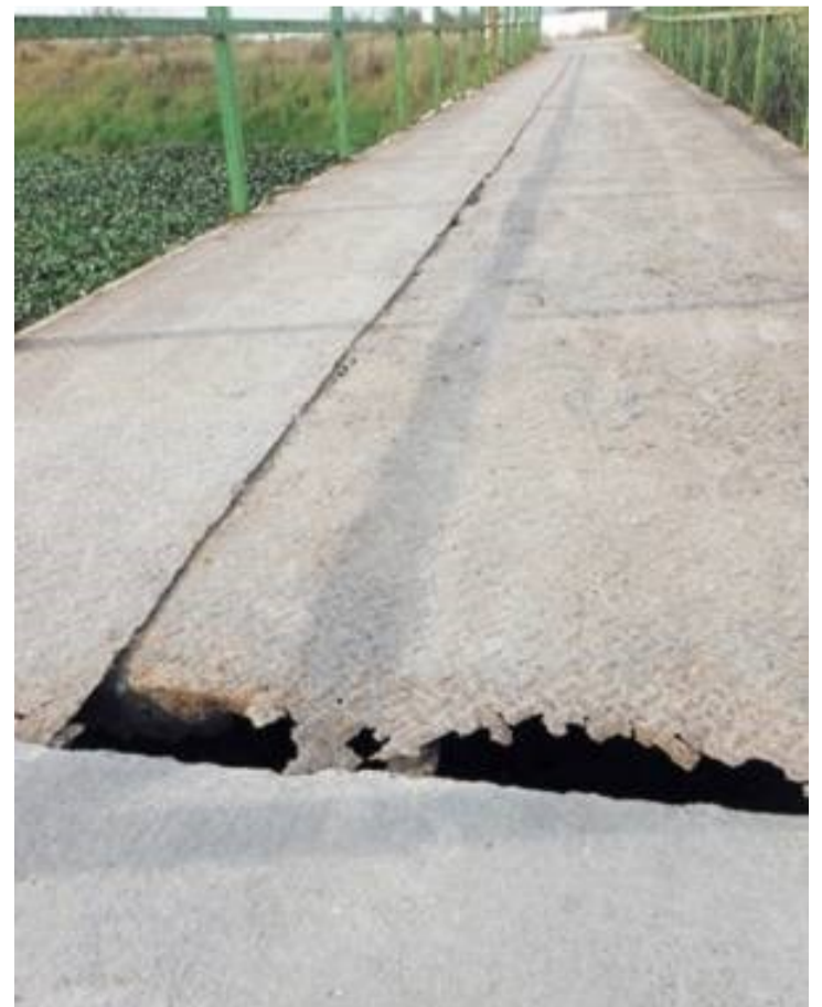
Deterioro del piso del cruce
